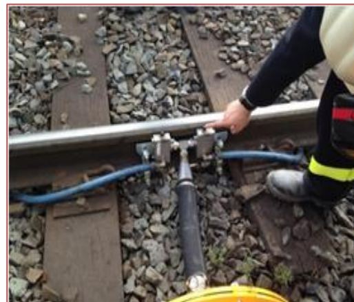
รูปแสดง Rail Grease Unit
